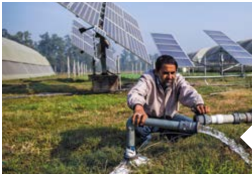
Bombeo de agua subterránea con energía generada por paneles solares en Jagadhri (India).
